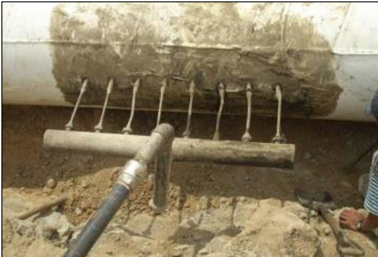
Perforación de tubería para robar crudo
