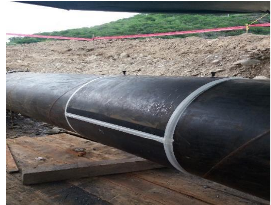
Reforzamiento de tubería (Riesgo por corrosión)
